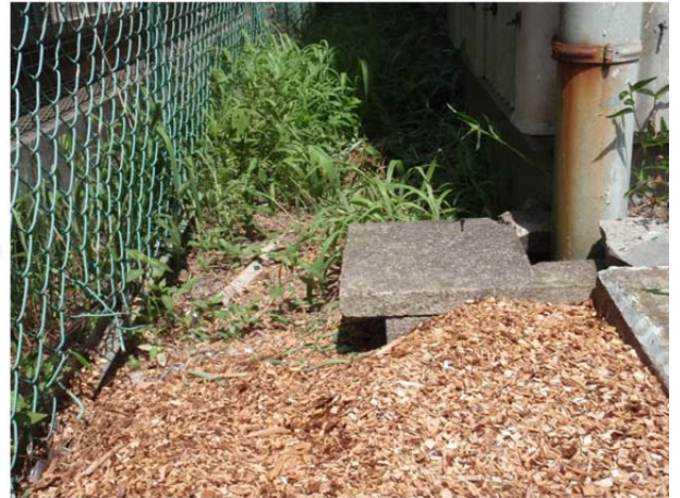
【↑施工していない場所は雑草が繁茂】
