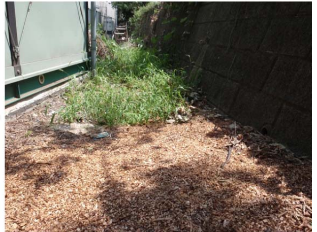
【↑施工していない場所は雑草繁茂】
